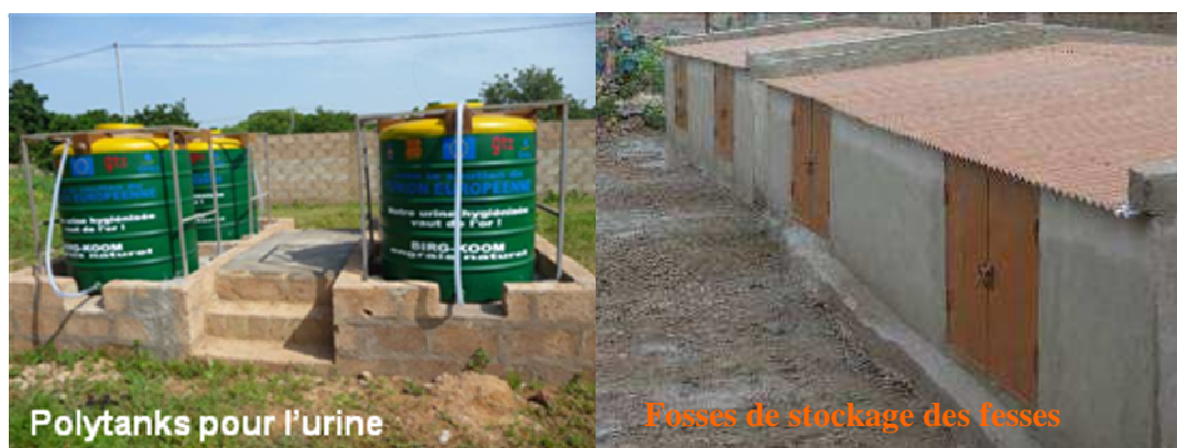
Figure 14: Quelques infrastructures du site d'hygiénisation
